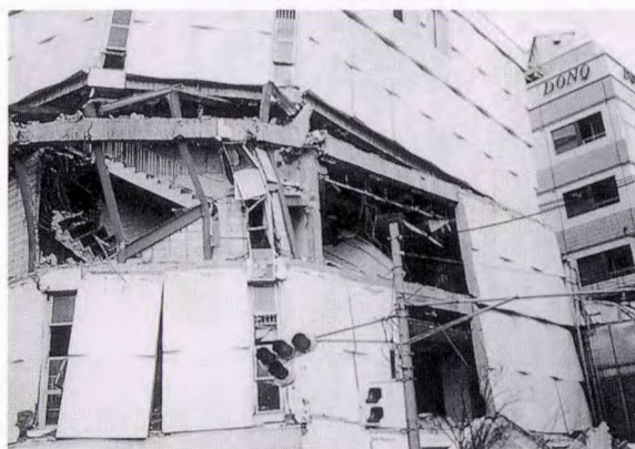
写真2 PCカーテンウォールの脱落
